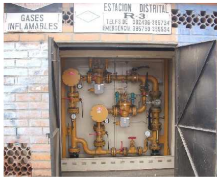
Figura 4: Estación de Regulación Distrital
